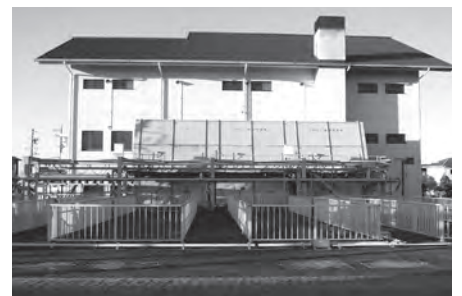
黒瀬ポンプ場
